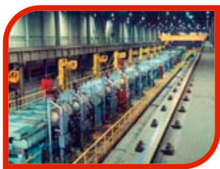
Installation de décapage HCL 33%, 80°C avec 120g/litre de particules d'oxyde de fer.
